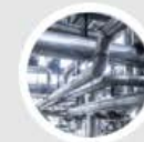
Transformación, material y tubos
